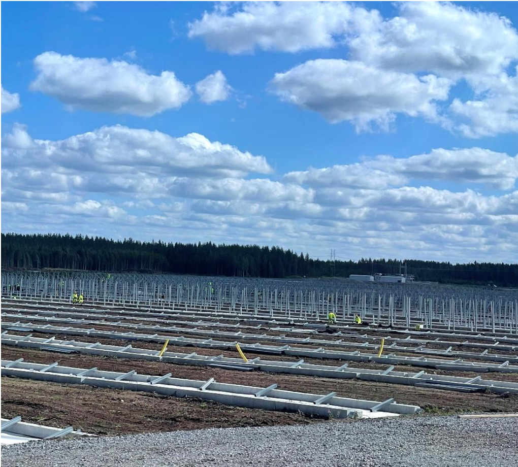
Kuva 1. EPV Energia rakentaa 100 MW aurinkovoimapuistoa Lapuan Heininnevan vanhan turvesuon alueella. Kuva: Vesa Hätilä.
